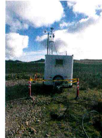
Vista frontal de la estación de calidad del aire
