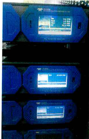
Vista interior de los analizadores de gases
