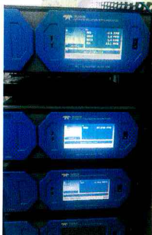
Vista interior de los analizadores de gases
