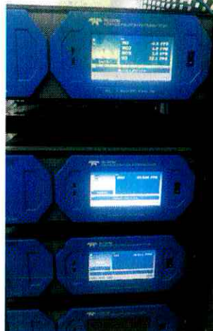
Vista interior de los analizadores de gases
