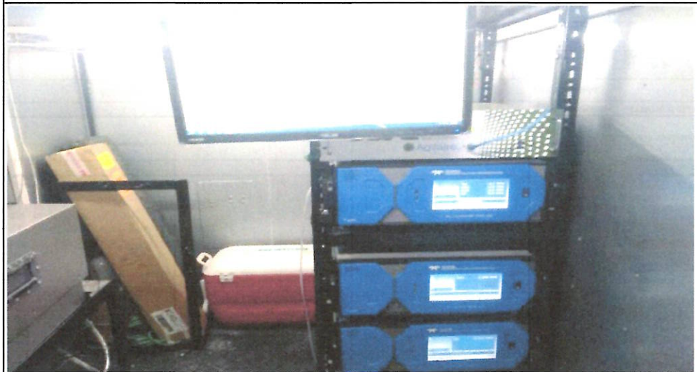
Vista interior de los analizadores de gases
