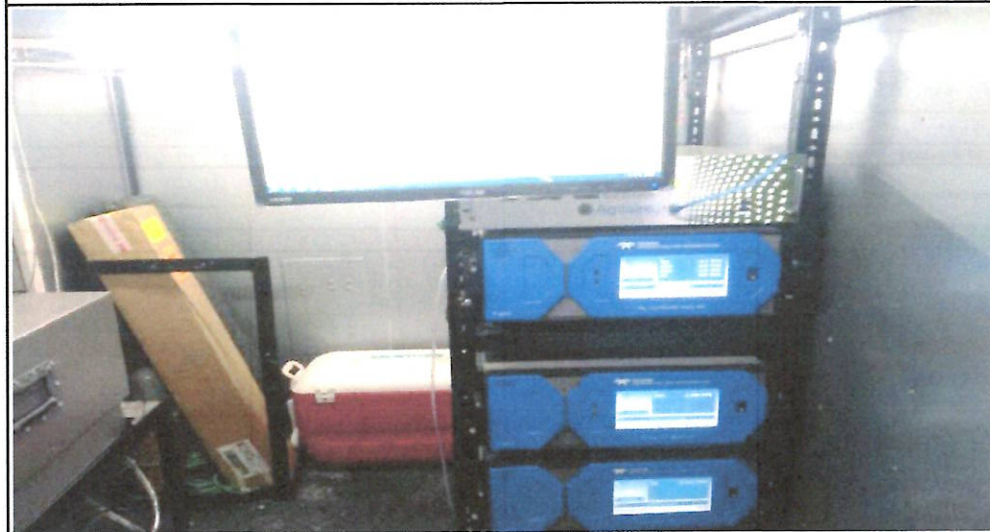
Vista interior de los analizadores de gases
