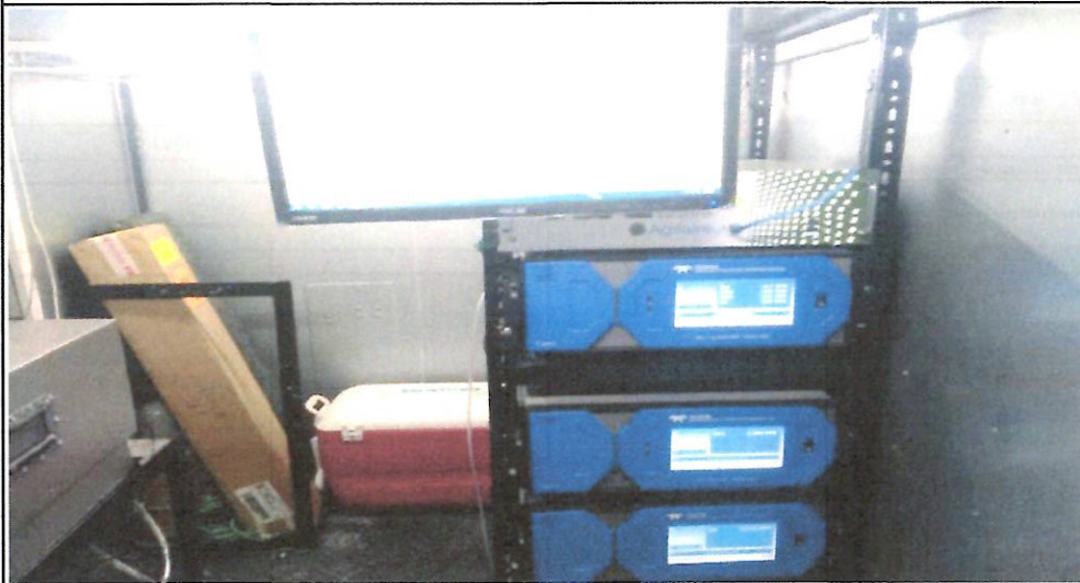
Vista Interior de los analizadores de gases
