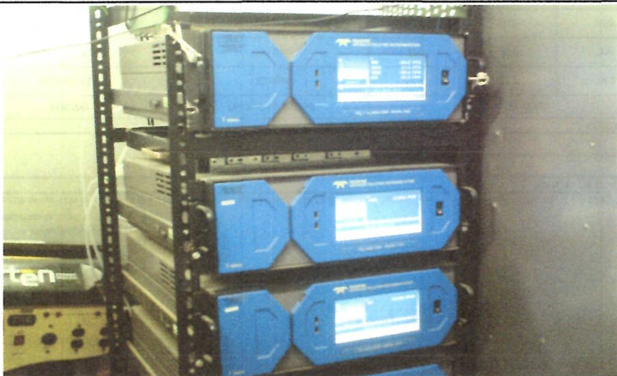
Vista interior de los analizadores de gases
