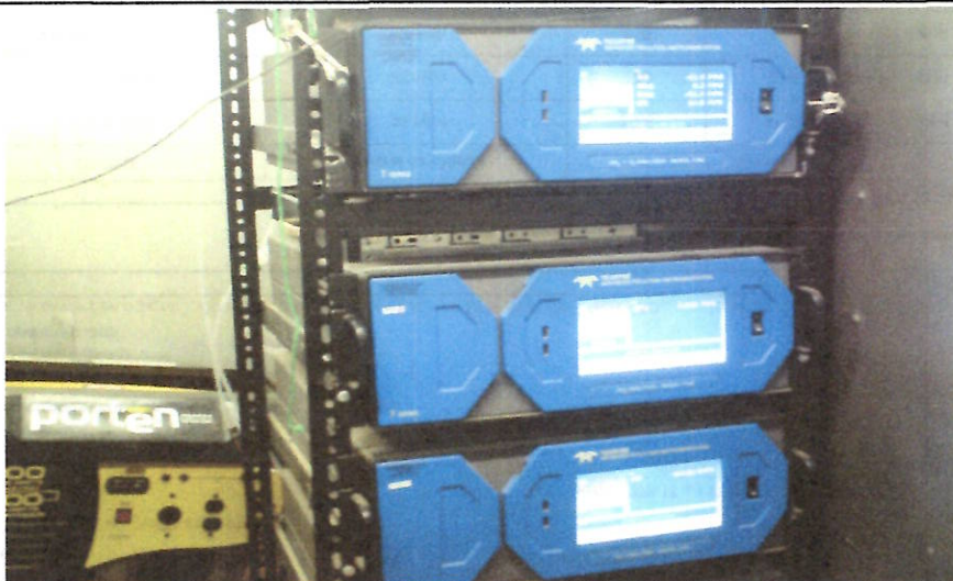
Vista interior de los analizadores de gases
